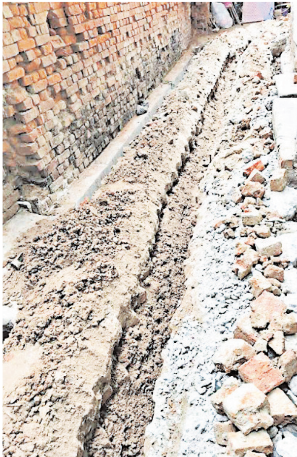
ठेकेदार द्वारा गड्ढा खोदकर छोड़ने के बाद पाइप बिछाने में समय ले रहे हैं। जहां पाइप लाईन का कार्य हो गया वहां की सड़को की मरम्मत नहीं हो सकी। इसका खामियाजा नगर के लोगों को भुगतना पड़ रहा है। वर्तमान समय में पूरे नगर की यही दशा है।
